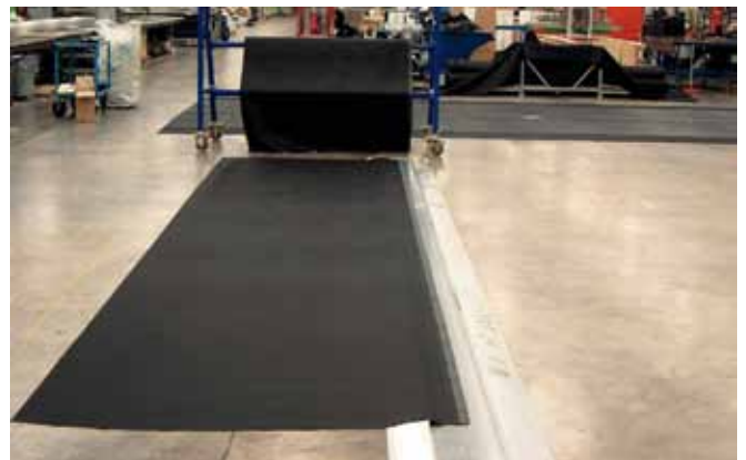
Rulla ut första dukvåden i önskad längd med den grå Thermobondkanten centrerad i styrskenan.
